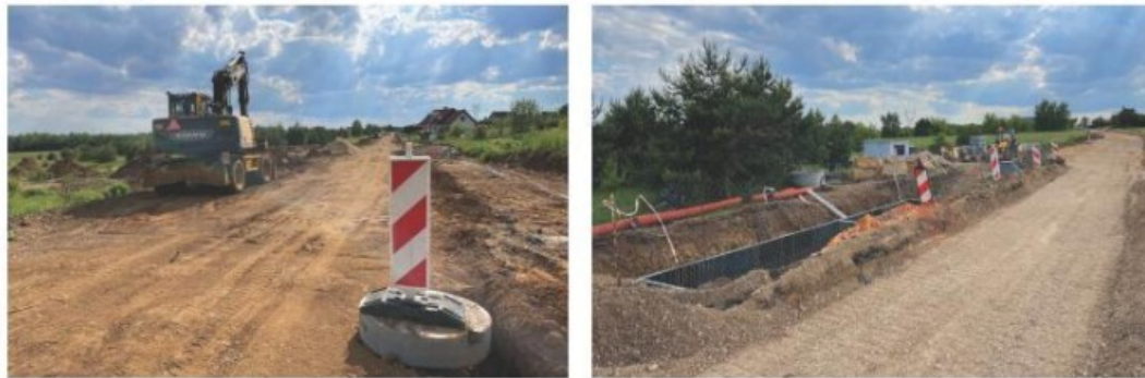
Przebudowa dróg gminnych na ulicach Radosnej i Szerokiej w Tuliszowie wraz z budową kanalizacji deszczowej i budową zbiornika retencyjno-rozsączającego.
